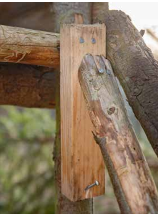
Hauptstützen dürfen nicht geschwächt oder repariert werden
